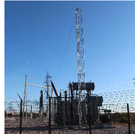
Les Mées sous-station électrique
